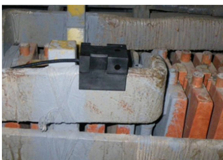
Abb.3 Eingebauter Sensor in einem Generator
